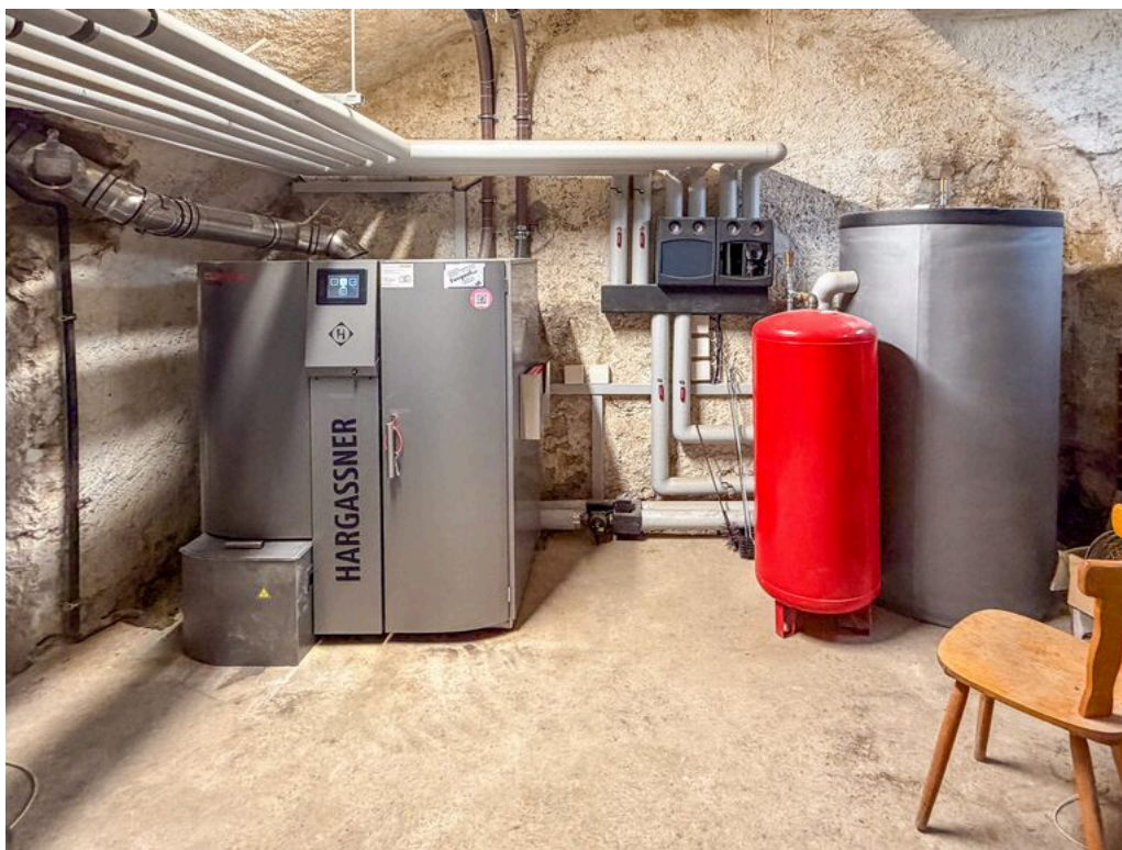
Immeuble - Sous-sol - local technique
