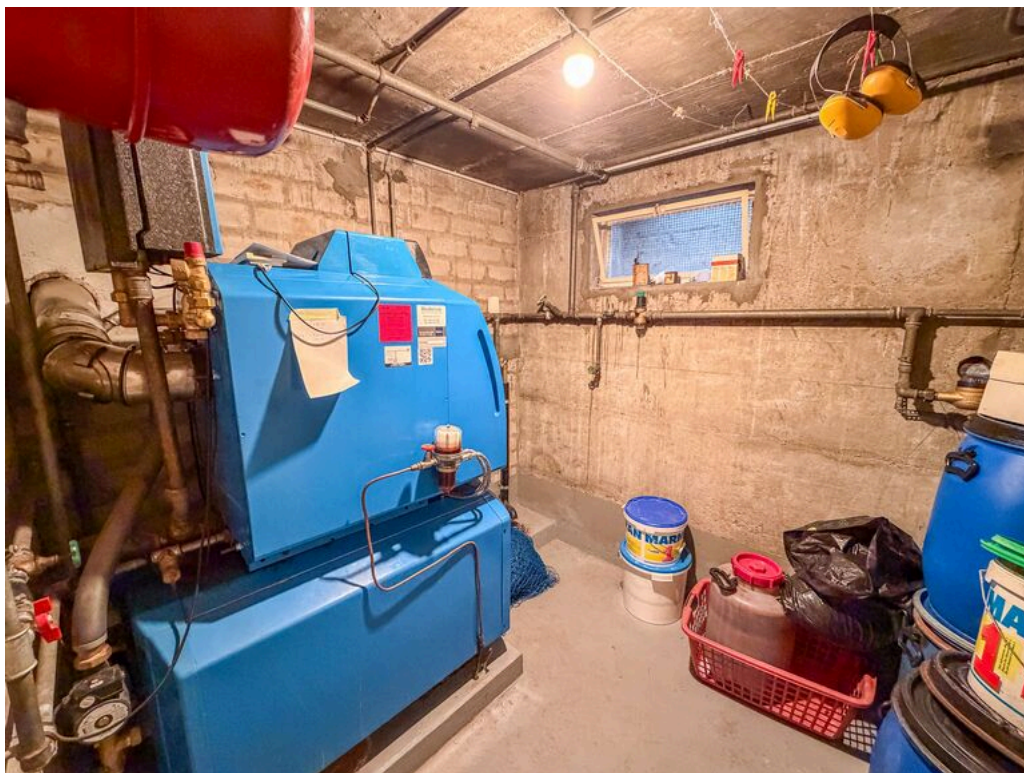
Rez-de-chaussée inférieur - local technique
