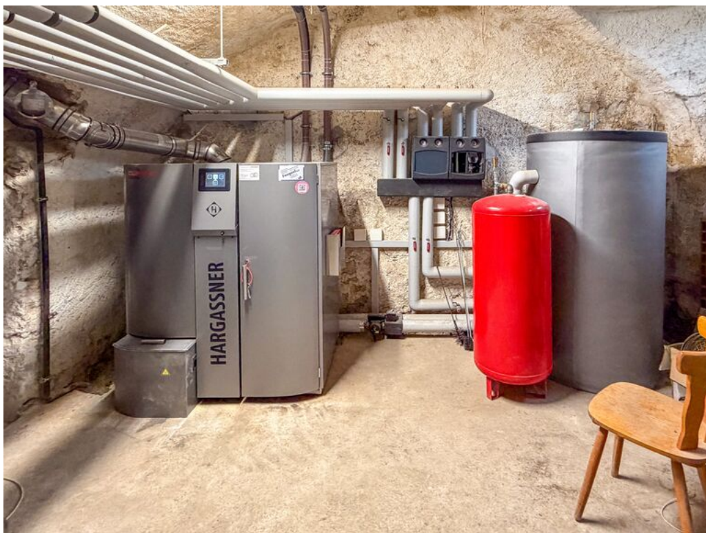
Immeuble - Sous-sol - local technique
